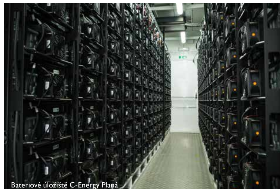
Bateriové úložiště C-Energy Planá
